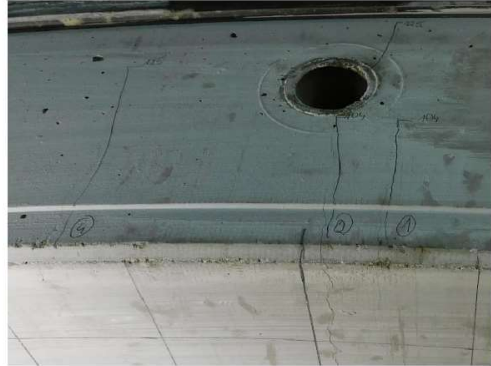
Fot. 12 Segment E - pierwsze powstające rysy nr 1 i nr 2 przy sile 104 kN
