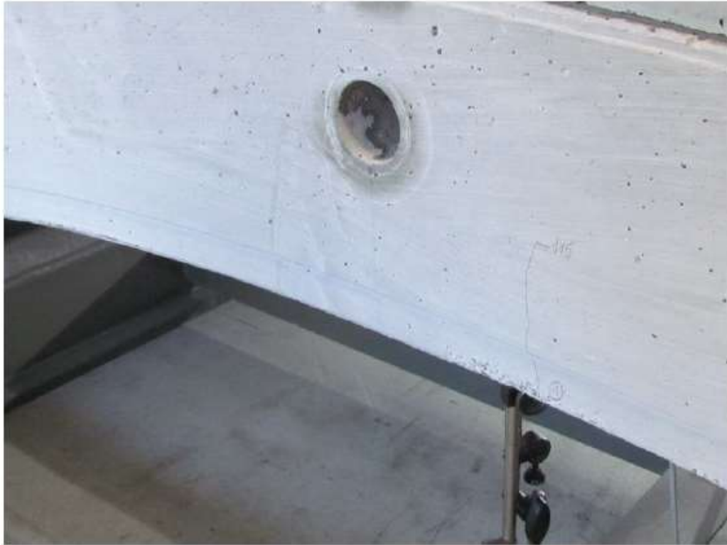
Fot. 6 Segment B - pierwsza powstająca rysa nr 1 przy sile 115 kN
